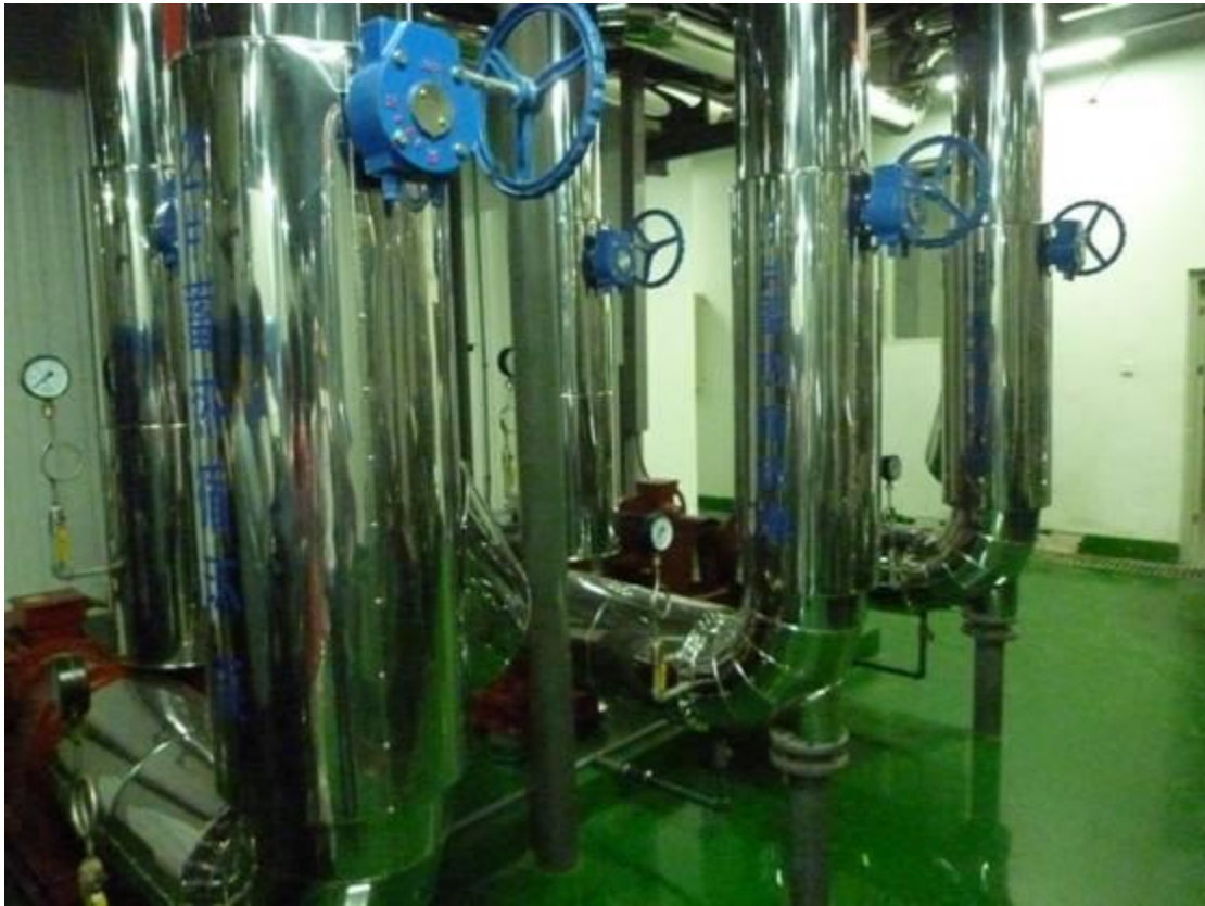
供热供冷系统
