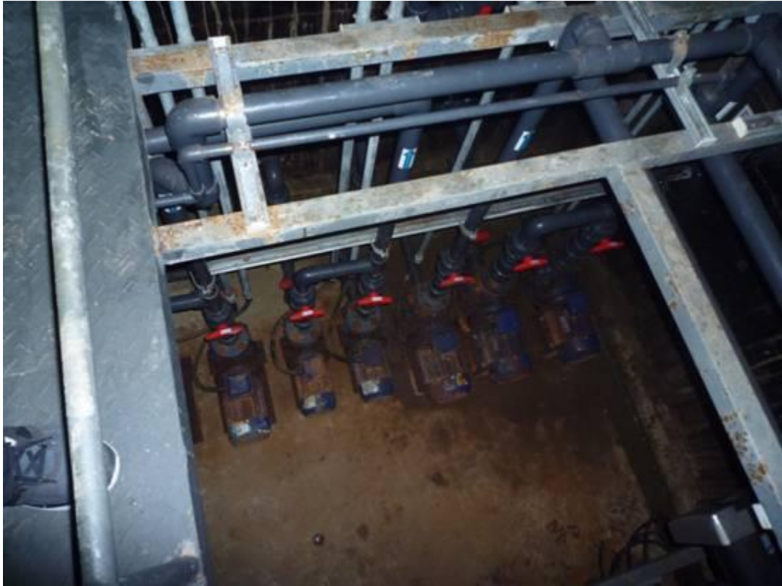
雨水集蓄系统
